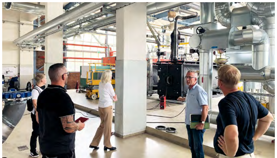
Besichtigung der Heizzentrale der LWL-Klinik Lippstadt am 13.08.21 (Foto: Frank Hockelmann)
